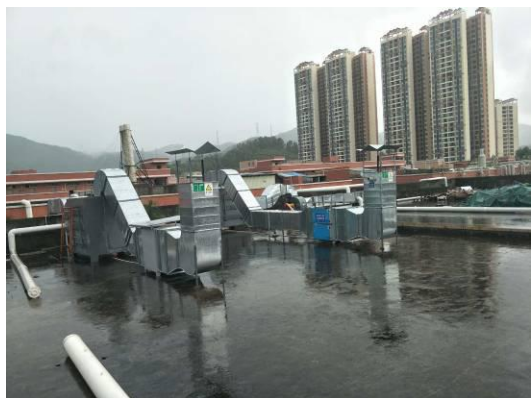
项目废气处理设施
