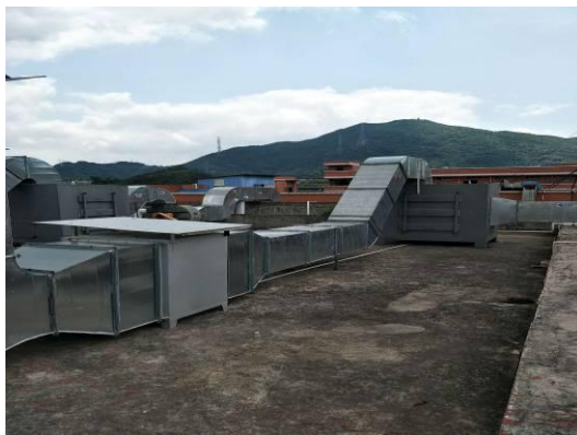
项目排气管道
