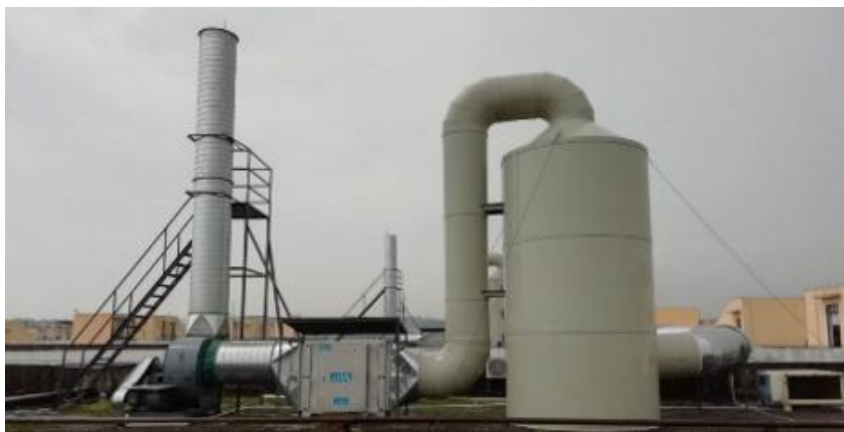
废气处理设施图
