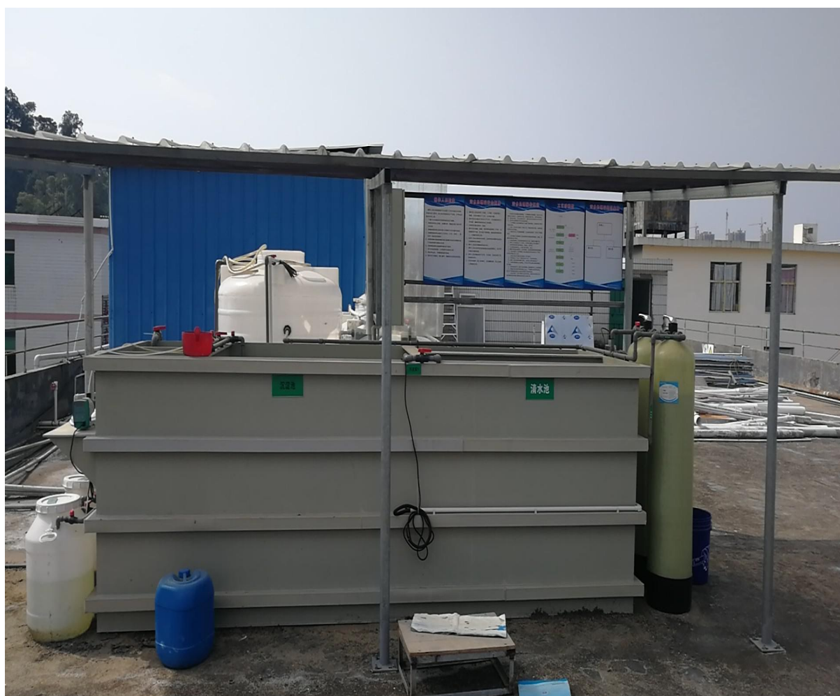
废水处理设施图
