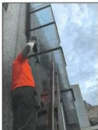
1 厂丝印废气检测口
