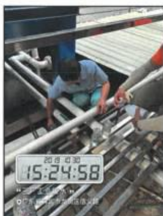
三厂污水处理池
