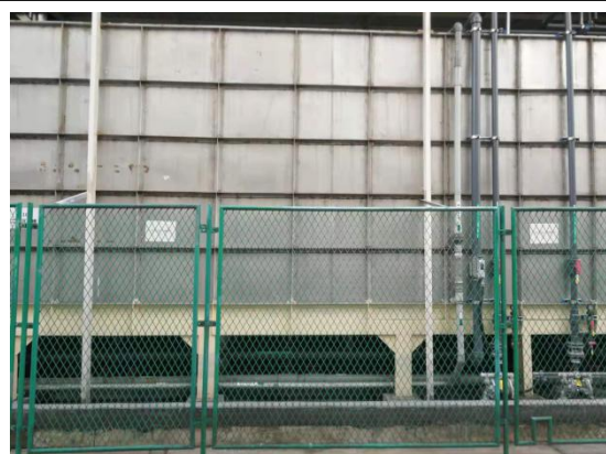
废水处理设施
