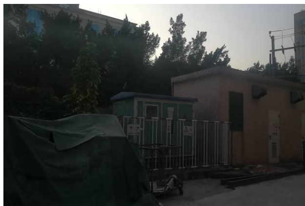
西侧 工业区配电房
