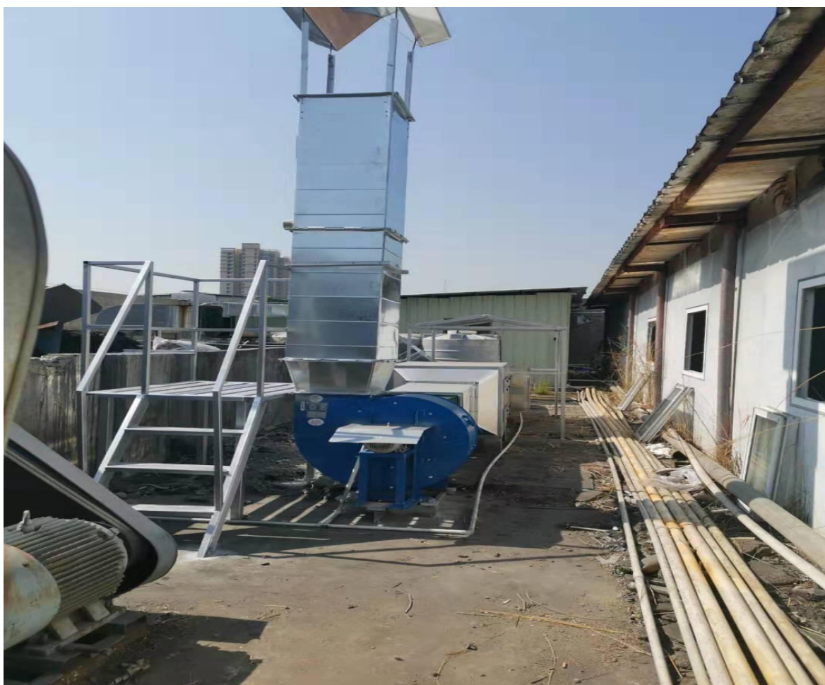
废气处理设施图
