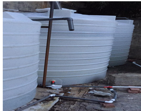
项目 1 楼污水回用设施入驻后现状
